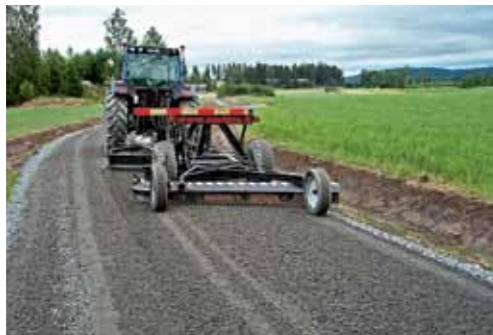
Ennen CC Roadin levitystä tie höylätään. Sivukaltevuuden tulisi olla 3–5 %, jolloin vesi valuu sivuojiin ja tie kuivuu nopeasti.
