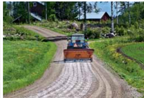
CC Road levitetään sirottelulaitteella ja sekoitetaan kulutuskerrokseen. Tiivis kulutuspinna viimeistellään jyrällä tai lanalla.
